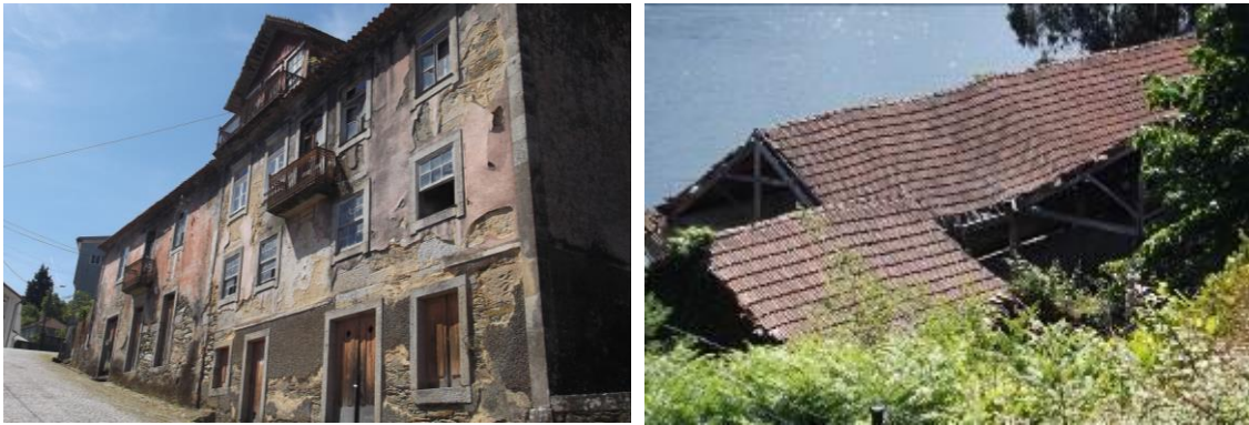
Figuras 6 e 7 | Edifício com necessidade de intervenção e pormenor da cobertura da antiga fábrica
